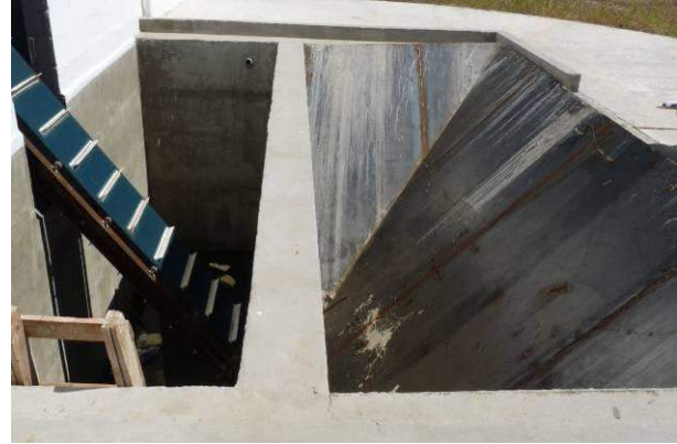
Tolva de recepción de residuos y cinta transportadora
