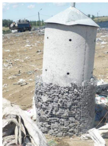
Conducción del biogás
